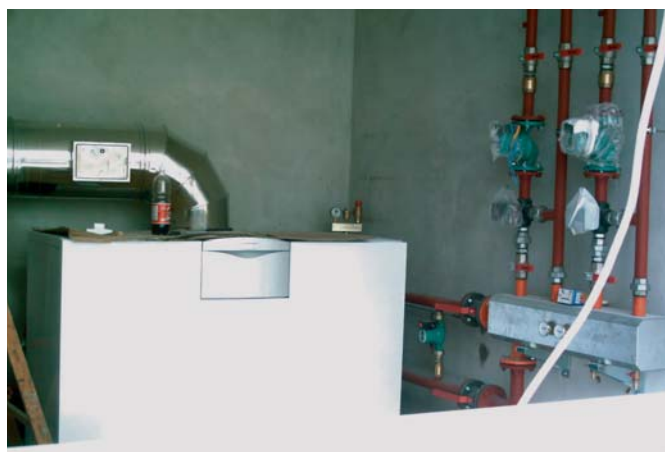
U kotlovnici tvrtke Zrinski-tehnologija gosp. Habek je projektirao isključivo Vaillant uređaje
