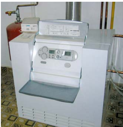
U kotlovnici Kuće sv. Franje ugrađen je kotao atmoVIT exclusive, 47 kW
