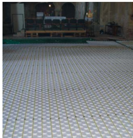
Crkva sv. Filipa i Jakova - izvođenje podnog grijanja i instalacija Vaillantovog fasadnog uređaja od 36 kW
