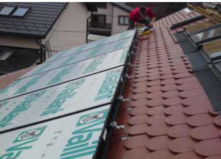
Referentni objekt u zagrebačkoj Dubravi: dizalica topline geoTHERM i solarni kolektori auroTHERM
