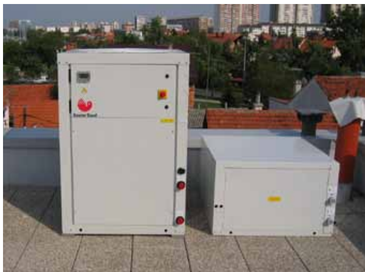
Referentni objekt Nobel nekretnine Energetix: Chilleri marke Saunier Duval
