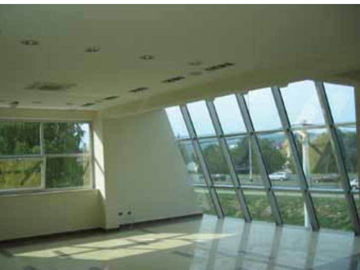
Referentni objekt Nobel nekretnine Energetix: ugradeni kasetni ventilokonvektori
