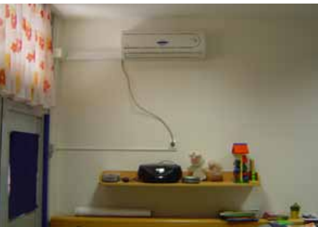
Unutrašnja jedinica u vrtiću Savska Domžale
